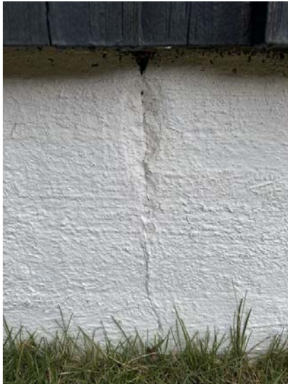
Viser sprekke i grunnmur.
