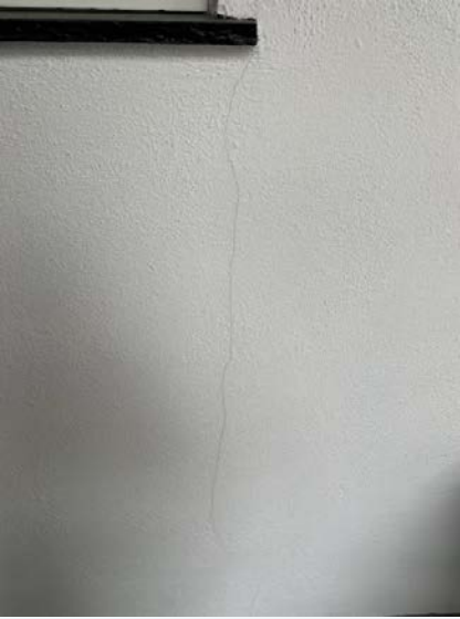
Viser sprekk i yttervegg ved inngangsparti.
