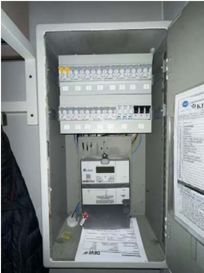
Viser sikringskap plassert i gang.
