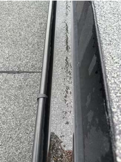
Takrenner må rengjøres.
