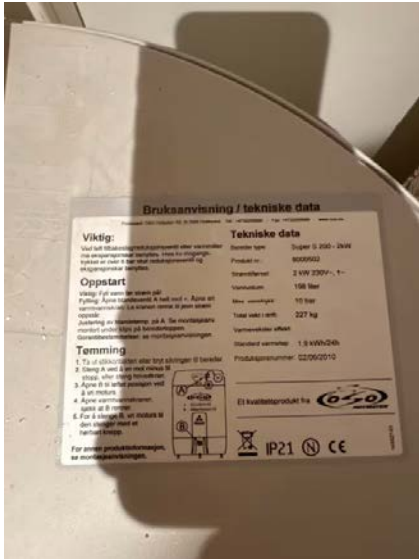
Viser teknisk data på bereder.
