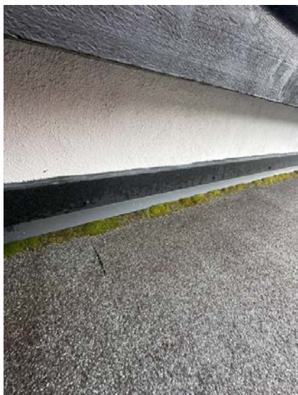
Det registreres mosegroing på taket. Dette reduserer levetiden på tekkningen.
