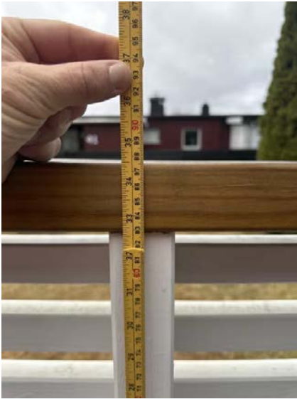
Viser røkkverkshøyde under krav.
