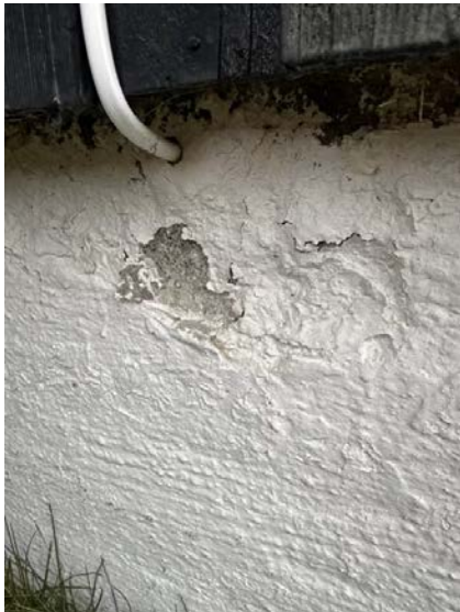
Viser avskalling av puss på grunnmur.
