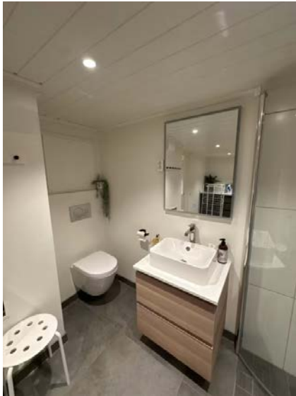
Viser baderomsinnredning og toalett med innebygget sisterner.
