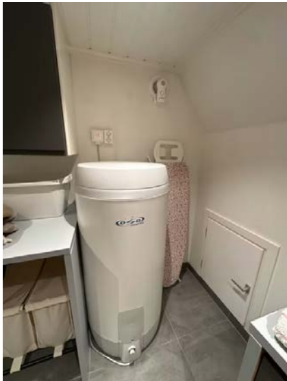
Viser plassering av varmtvannsbereder.
