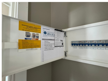
Sikringsskap i leiligheten.
