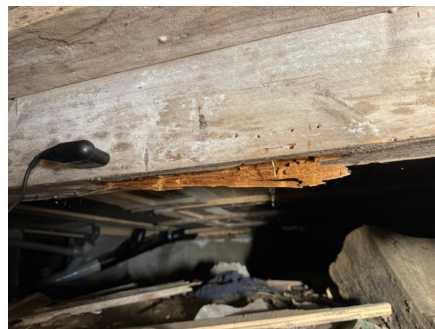
Eksempel på råteskade.
