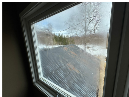
Vindu på loftet er sprukket.
