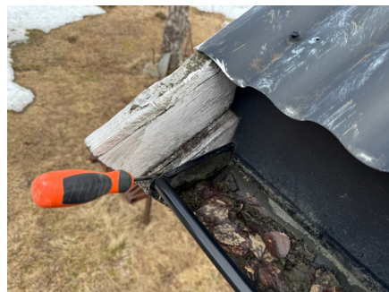
Eksempel på råteskadet vidskibord.
