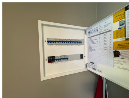
Sikringsskapet i boligen.
