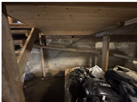
Det er langt mellom festene til avløpsrøret.
