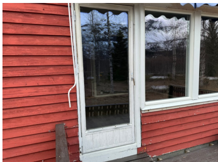
Balkongdøren er værslitt.
