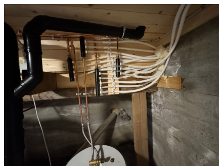
Samlestokk til vannledningene.
