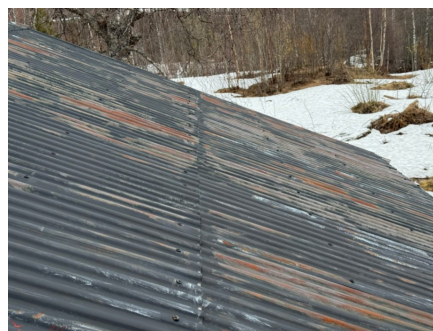
Rust på taktekingen.
