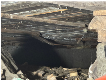
Eksempel på råteskade.
