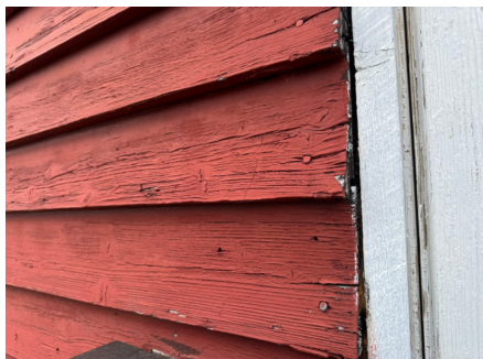
Eksempel på værslitt kledning.
