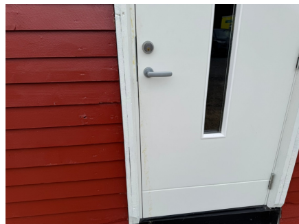
Ytterdøren tar i karmen.
