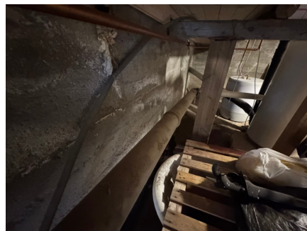
Det er langt mellom festene til avløpsrøret.
