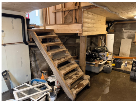
Det er ikke montert rekkverk på trappen ned til kjelleren.
