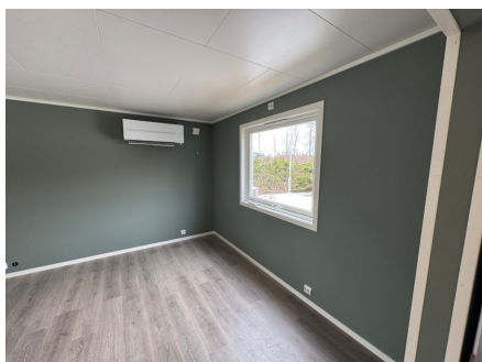
Varmepumpe montert i stuen.
