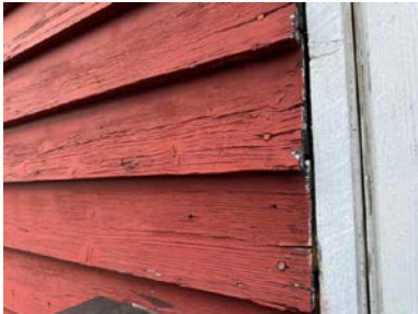
Eksempel på værslitt kledning.
