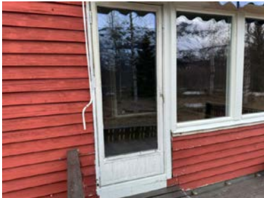
Balkongdøren er værslitt.
