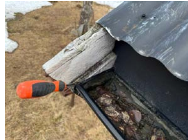
Eksempel på råteskadet vidskibord.
