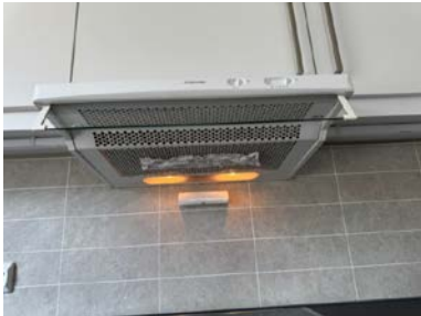
Funksjonstest av ventilatoren.
