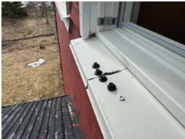
Ufagmessig utførelse av beslag under vinduet.
