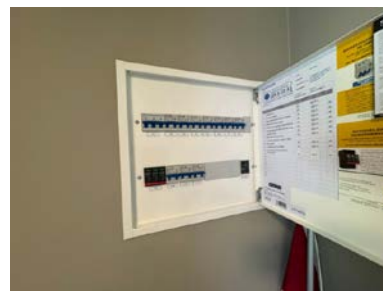
Sikringsskapet i boligen.
