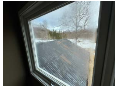
Vindu på loftet er sprukket.
