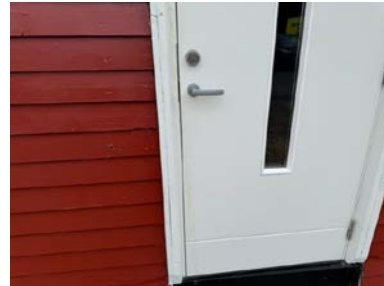
Ytterdøren tar i karmen.
