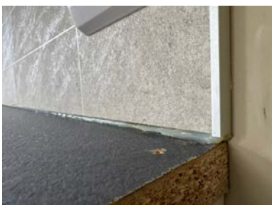
Det er svikt i fugen mellom kitchenboard og benkeplaten.
