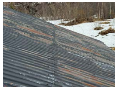
Rust på taktekkingen.
