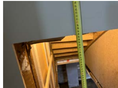
Det er liten overhøyde på trappen ned til kjelleren.
