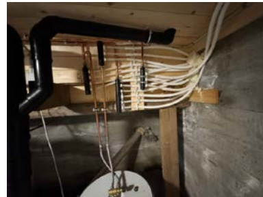
Samlestokk til vannledningene.
