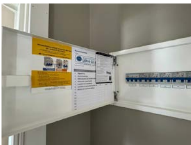
Sikringsskap i leiligheten.
