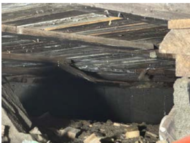
Eksempel på råteskade.
