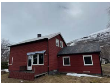
Det er ikke montert snøfangere hvor folk kan ferdes.
