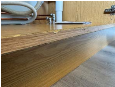
Fuktsvelling i bunnplate i skap.
