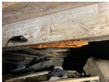
Eksempel på råteskade.
