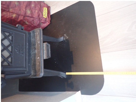
For kort avstand mellom ildsted og brennbart materiale.
