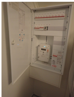
Sikringskap med automatsikringer.
