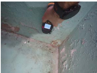
Avvik ved fuktsøk i nedre deler av grunnmur
