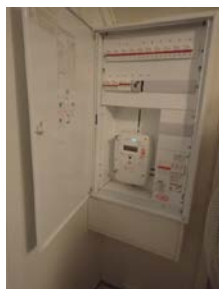
Sikringsskap med automatsikringer.
