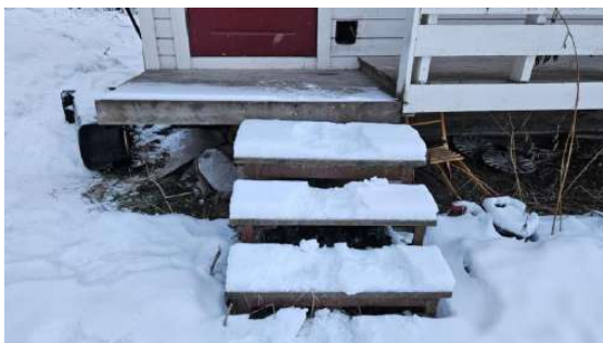
Rekkeverk mangler ved trapp.
