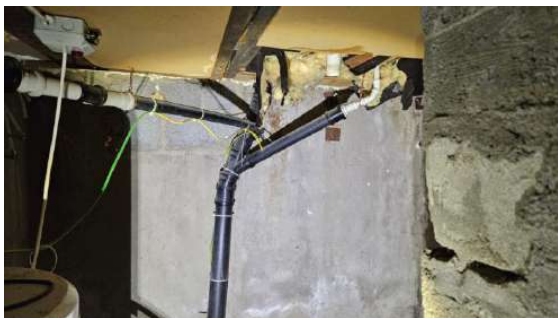
Avløpsledning ufagmessig utført.
