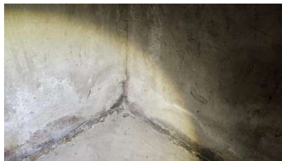
Sverte sopp mot yttervegg.
