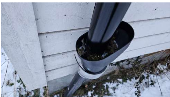
Tilkobling drenering må rengjøres.
