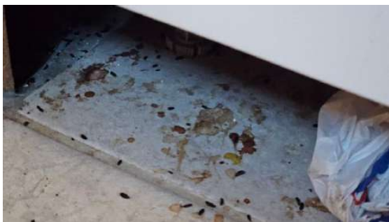
Spor av mus ved oppvaskmaskin.
