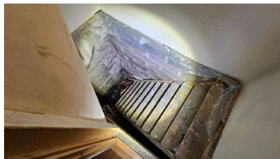
Mangler rekkverk og håndløper i trapp ned til kjeller.
