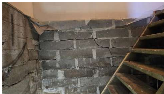
Sprekker i grunnmur.
