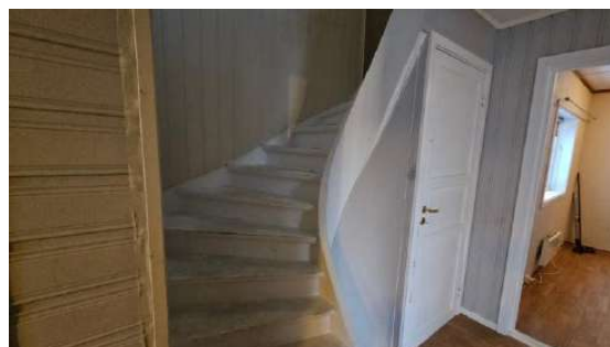
Mangler rekkverk og håndløper i trapp fra hovedplan til loftsetasje.
