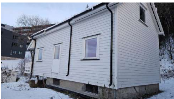
Trapp/balkong mangler ved terrassedør, dør må sikres for fall ut av dør.
