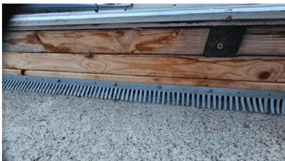
Musebånd er montert feil.
