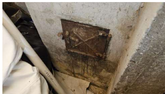
Sotluke kjelleretasje mye rot ligger mot sotluke.
