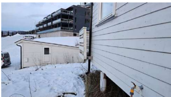
Mangler rekkeverk mot hjørnet på yttervegg
