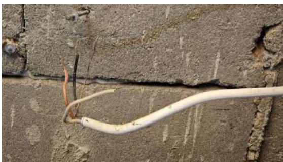
Løse ledning i kjeller
