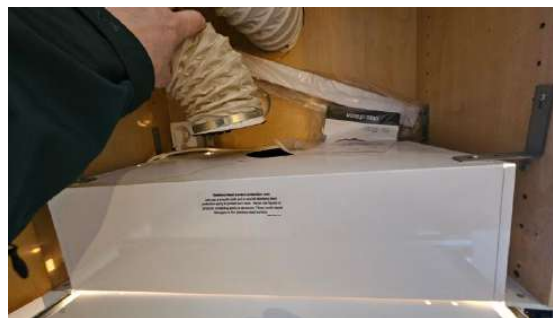
Kanal kjøkken ventilator ikke tilkoblet.
