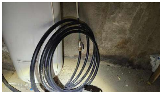
Vannledninger ufagmessig utført.
