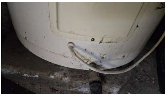
Varmtvannsbereder er produktmerkingen borte.
