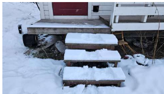
Trapp mangler rekkeverk.
