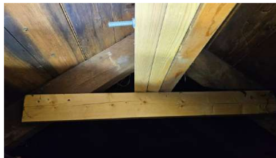
Dårlig opplegg for drager i takkonstruksjon.
