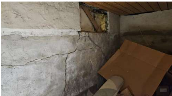
Sprekker i grunnmur.
