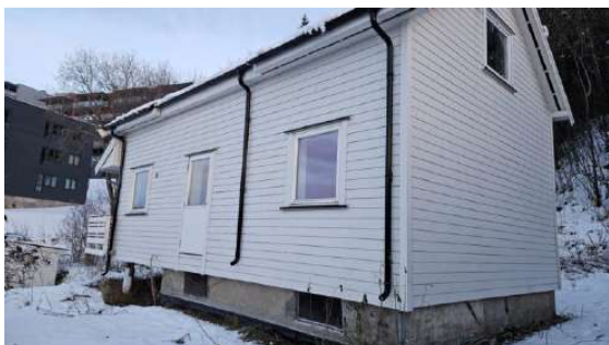
Taknedløp ikke koblet til drenering.
