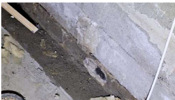
Fukt ved yttervegg.
