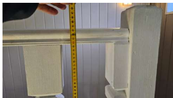
Høyde rekkverk er for lav.
