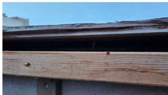
Manglende musebånd bak kledning.
