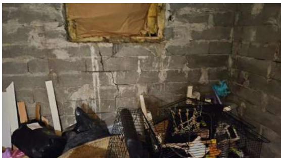
Sprekker i grunnmur.
