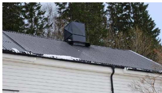
Pipebeslag ikke tilfredsstillende innfestet.
