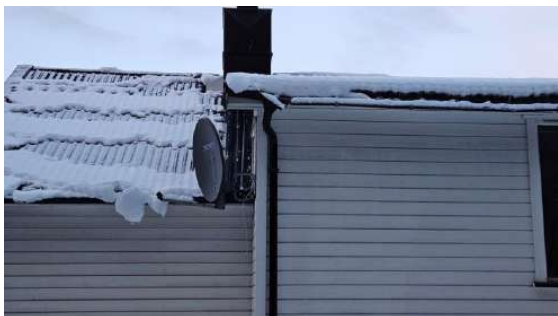
Stige til pipe mangler.
