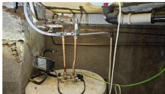
Vannledninger ufagmessig utført.
