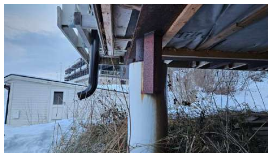
Manglende musebånd bak kledning.
