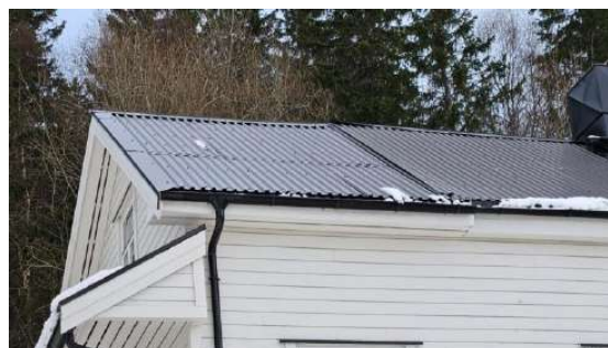
Takplater ikke tilfredsstillende innfestet.
