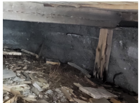
Råteskade på trepilar i krypkjeller
