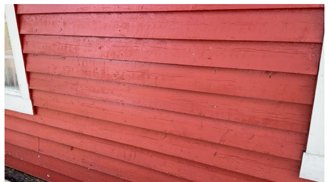
Sprekker i kledning på eldre del
