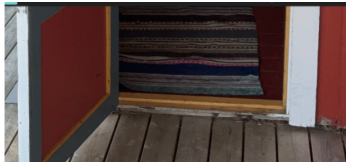
Manglede beslag under dør.
