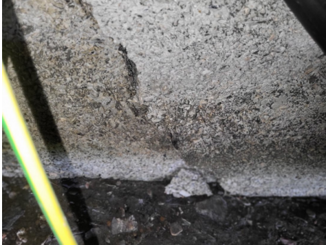
Sprekk i grunnmur.
