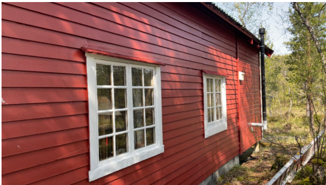
Det er ikke montert beslag under vinduer.
