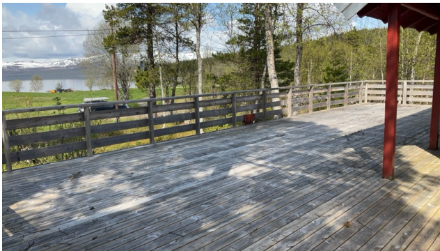
Slitasje på terrassedekke
