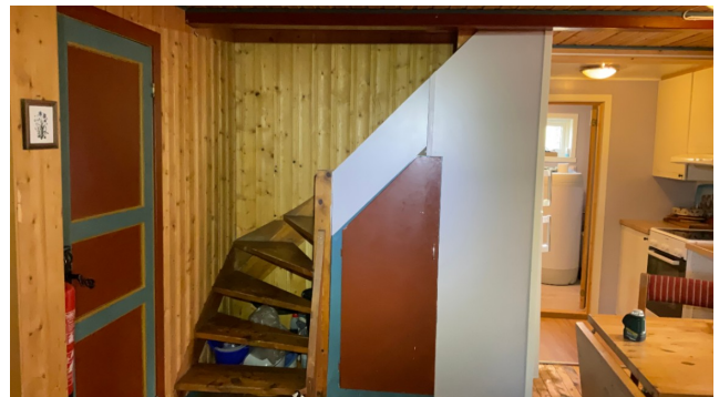
Det er ikke montert rekkverk.
