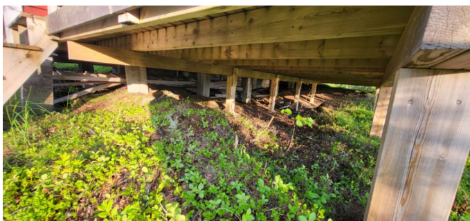
Manglende under terrasse pilar ved trapp
