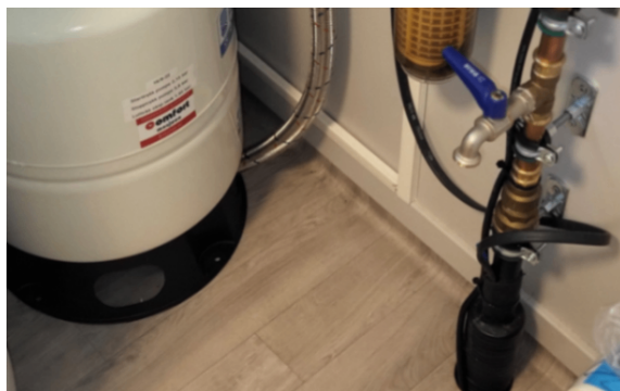
Oppbrett på gulfbelegg mot vegg.
