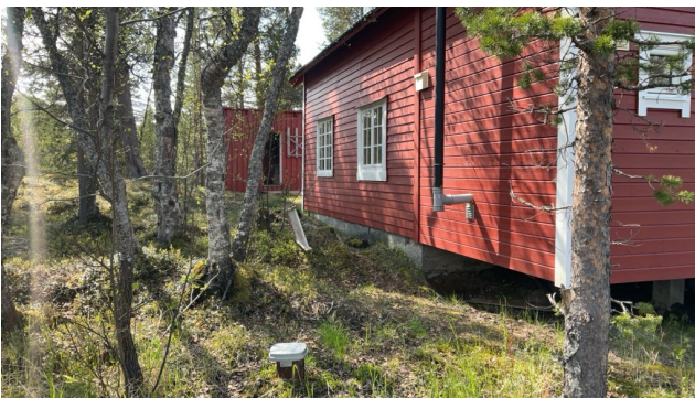
Dårlig fall ut fra bygning mot vest.
