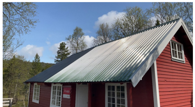
Synlige skjevheter i takkonstruksjonen.
