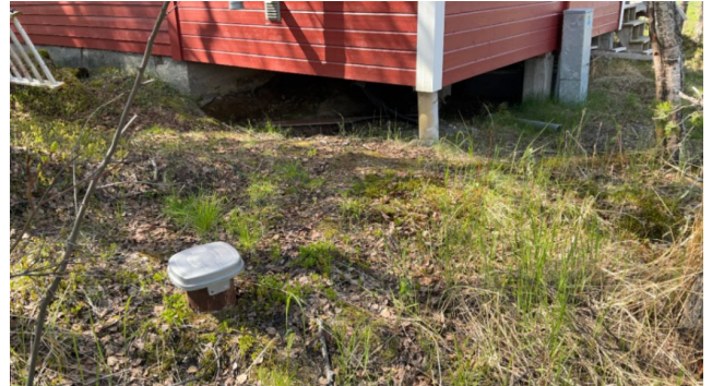
Skjevhet i pilar under tilbygg.
