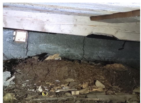
Sprekk i grunnmur. Manglende rist i lufteventil.
