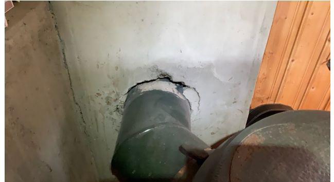
Sprekker i tetting rundt røykrør.
