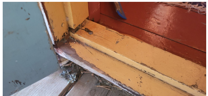
Sprekker og åpninger i karm.
