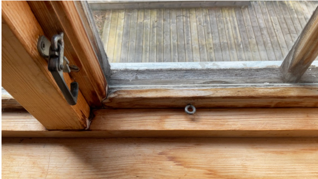
Råteskader i karm.
