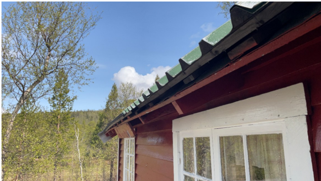
Manglende takrenner og nedløp.
