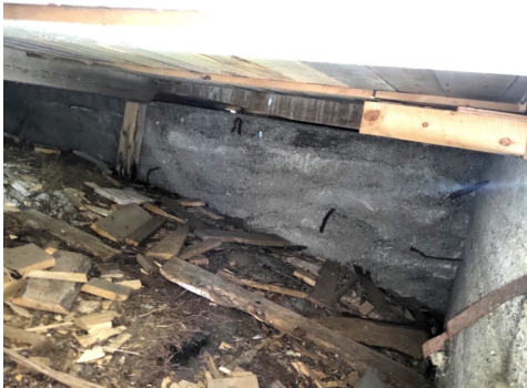
Råteskadet pilar under bjelkelag i kjeller.
