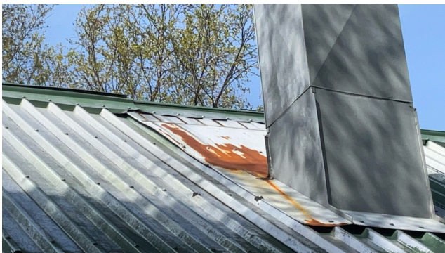
Rust på beslag over pipe.
