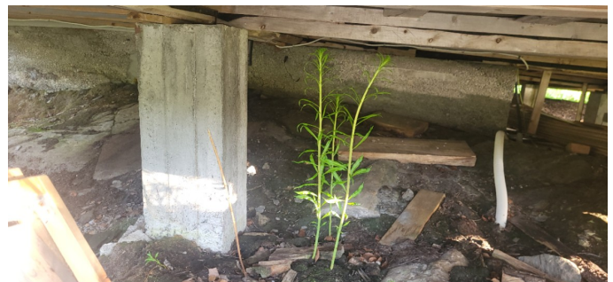
Skjevhet i pilarer under tilbygg
