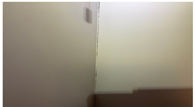
Sprekk i hjørne på veggplater
