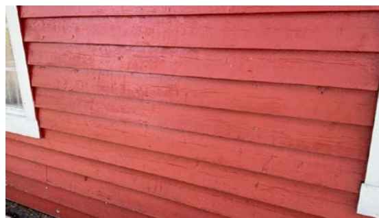
Sprekker i kledning på eldre del
