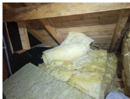
Ufullstendig isolering og muselort
