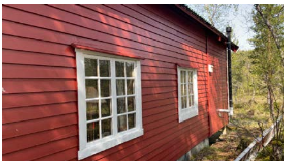
Det er ikke montert beslag under vinduer.
