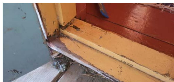
Sprekker og åpninger i karm.
