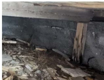
Råteskade på trepilar i krypkjeller
