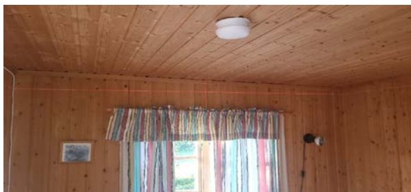
Ca. 5 cm. skjevhet under himling på tilbygd soverom
