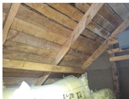
Svak konstruksjon og isolering som ikke er pakket opp.
