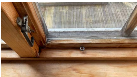
Råteskader i karm.
