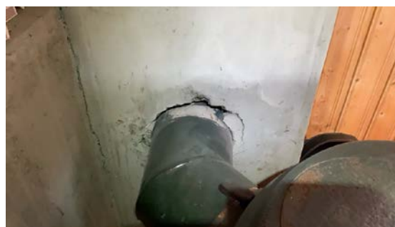
Sprekker i tetting rundt røykrør.
