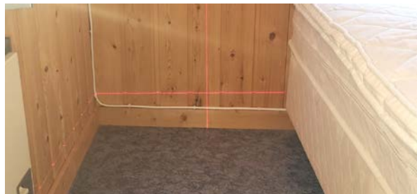
Synlig planavvik gulv soverom 1. etasje.
