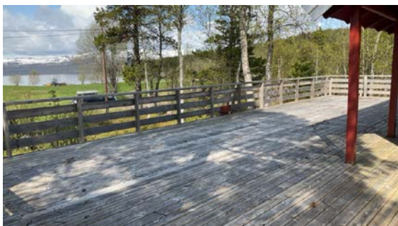
Slitasje på terrassedekke
