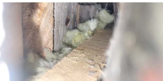
Manglende musekloss bak kledning gammel del.
