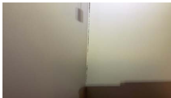
Sprekk i hjørne på veggplater
