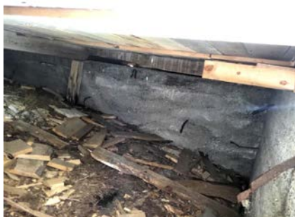
Råteskadet pilar under bjelkelag i kjeller.
