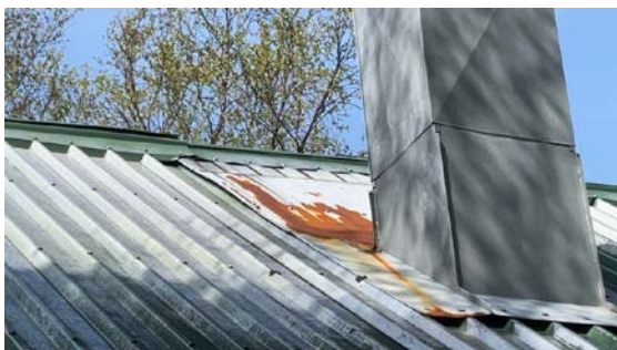
Rust på beslag over pipe.
