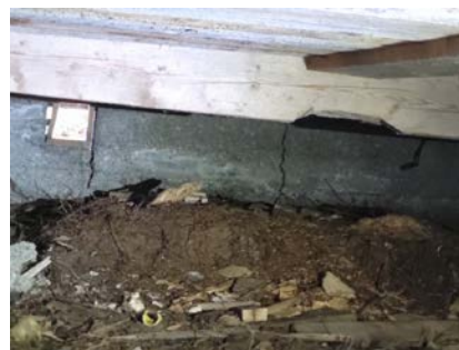
Sprekk i grunnmur. Manglende rist i lufteventil.
