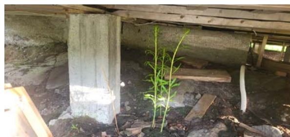
Skjevhet i pilarer under tilbygg
