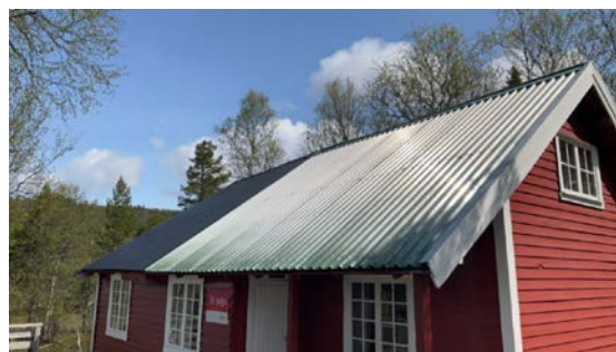
Synlige skjevheter i takkonstruksjonen.
