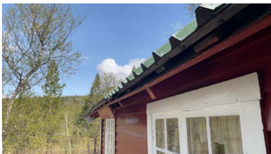
Manglende takrenner og nedløp.
