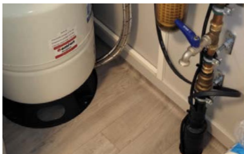
Oppbrett på gulvbelegg mot vegg.
