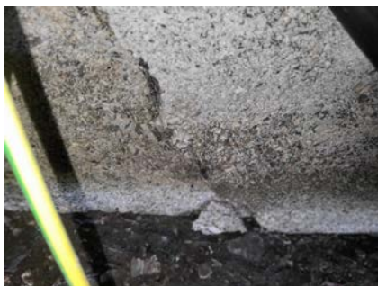
Sprekk i grunnmur.
