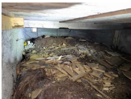
Trematerialer i krypekjeller bør fjernes.
