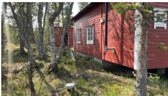
Dårlig fall ut fra bygning mot vest.
