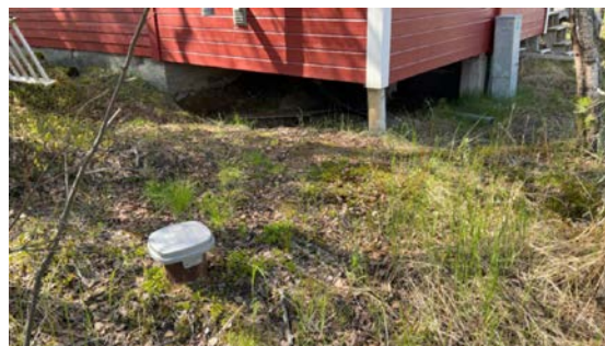
Skjevhet i pilar under tilbygg.
