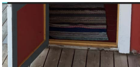
Manglede beslag under dør.
