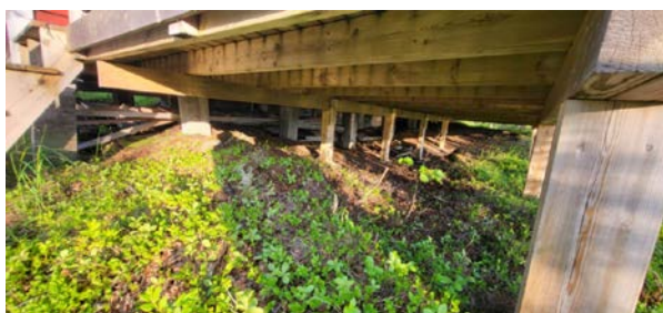
Manglende under terrasse pilar ved trapp
