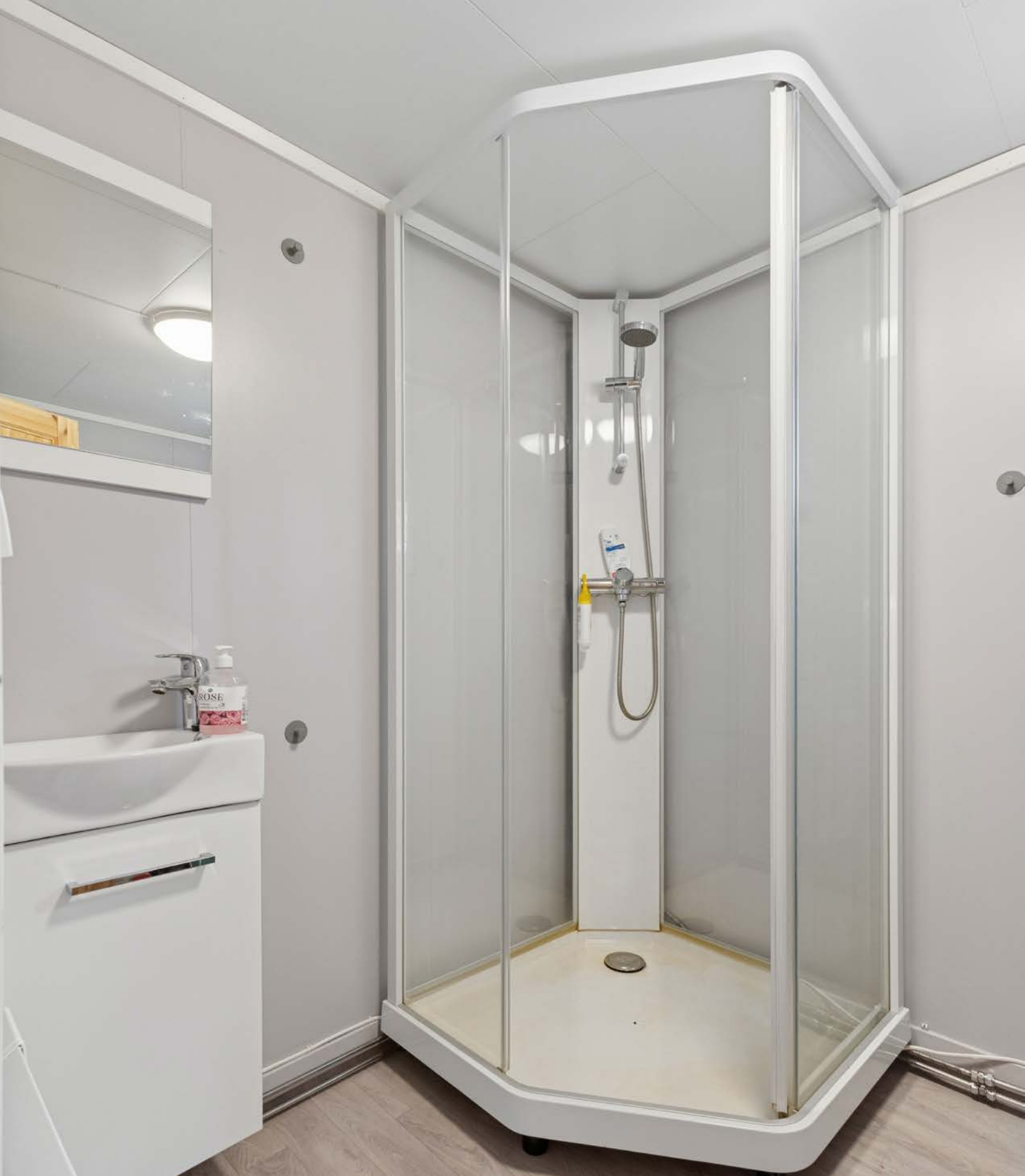
Bad med dusjkabinett. Avløp for gråvann fra vasken og dusjen går til terreng
