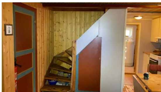
Det er ikke montert rekkverk.
