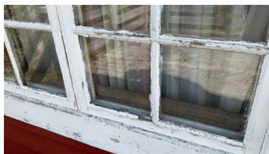
Råteskader i koblete vinduer. Kitt på ruter er sprukket.
