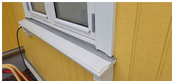
Løst beslag under vindu, lite fall ut fra vindu
