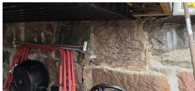
sprekker i grunnmur
