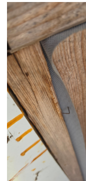
Ingen synlig lufting nederkant kledning
