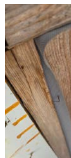
Ingen synlig lufting nederkant kledning
