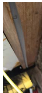
Ingen synlig lufting nederkant kledning
