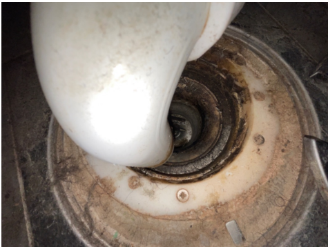
Sluk under dusjkabinett
