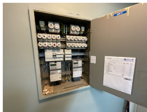
Sikringsskap i felles trappegang
