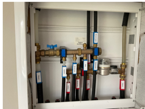
Rør i rør skap på kjøkkenet
