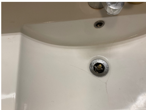
Sprekk i servanten
