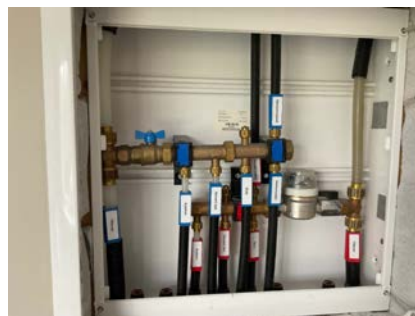
Rør i rør skap på kjøkkenet
