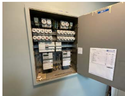
Sikringsskap i felles trappegang
