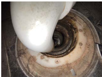
Sluk under dusjkabinett
