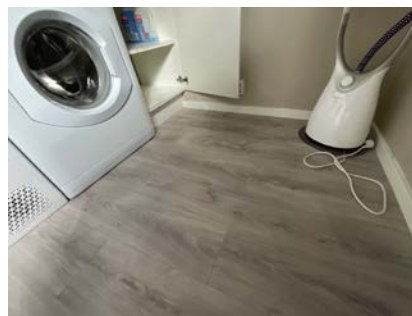
Svelling i laminatgulvet på kjøkkenet
