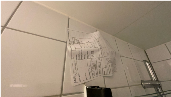
Test med løst ark viste tilfredstillende avtrekk.
