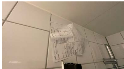
Test med løst ark viste tilfredstillende avtrekk.
