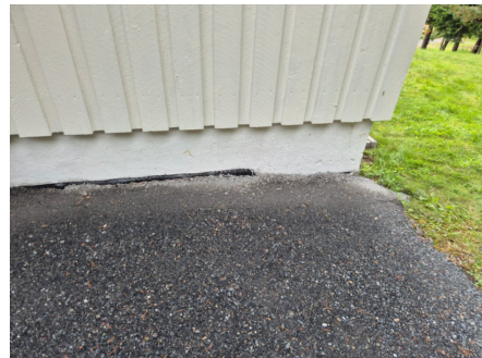
Synlig vorteplast og noe under terreng.
