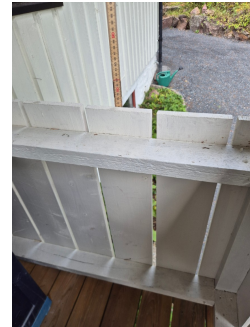
Mangler toppbord og lavt rekkverk.
