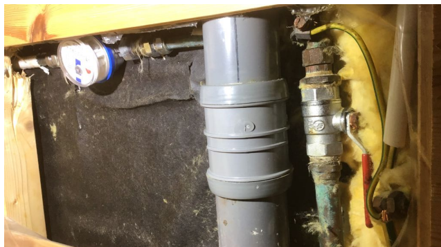
Vannmåler og stoppekran i luke på kontor
