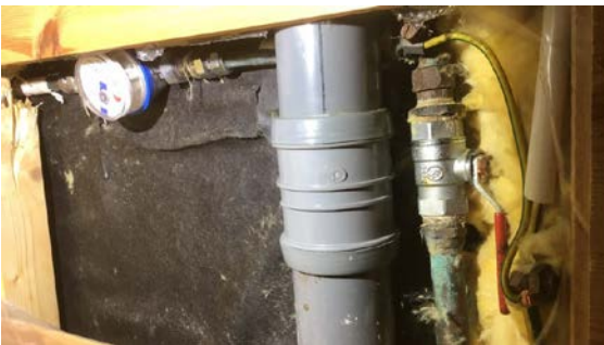
Vannmåler og stoppekran i luke på kontor
