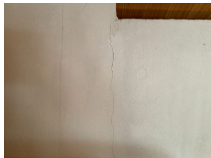
Sprekk i brannmur.
