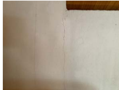
Sprekk i brannmur.
