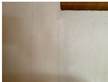
Sprekk i brannmur.
