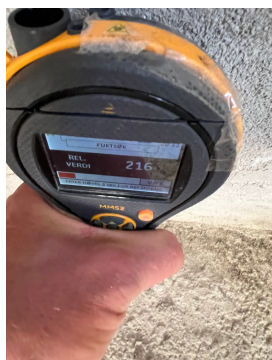
Fuktutslag i nedre del av grunnmur
