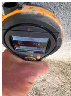
Fuktutslag i nedre del av grunnmur
