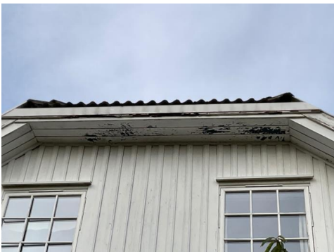
Råte på vindskier og takrennebord.
