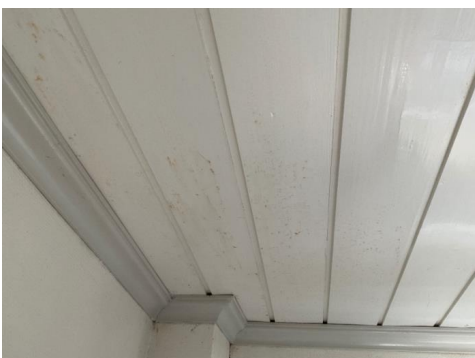
Skjoldet i tak på bad
