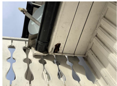
Råte i takstikk ved inngangsparti.
