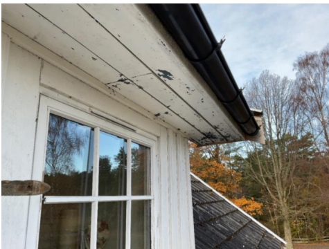
Malingsflass på fasader.
