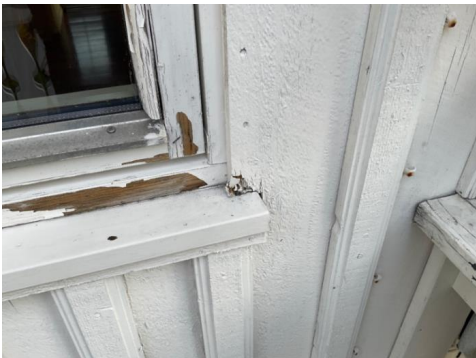
Malingsflass på vinduer.
