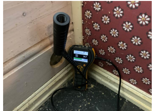
Fuktmåling i utforet vegg.
