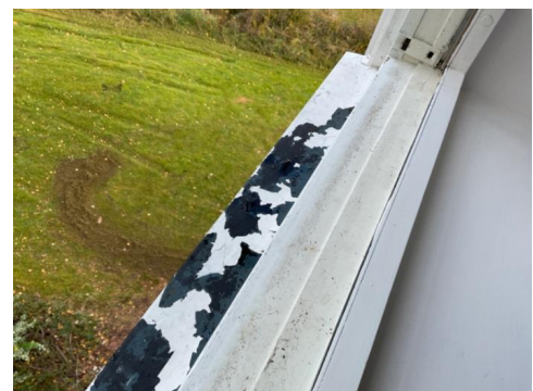
Malingsflass på vannbrett.
