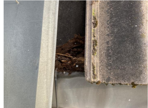
Råte under takstein.
