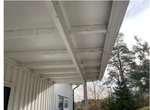
Drager/bjelke som er underdimensjonert.
