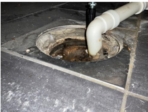
Sluk under dusjkabinett
