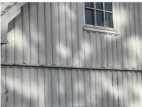
Råte på kledning.
