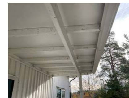
Drager/bjelke som er underdimensjonert.
