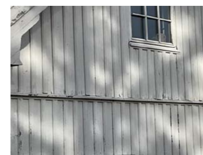
Råte på kledning.
