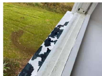
Malingsflass på vannbrett.
