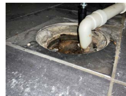
Sluk under dusjkabinett
