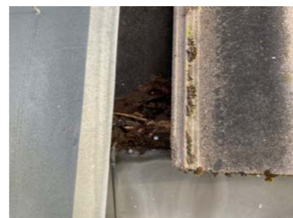
Råte under takstein.
