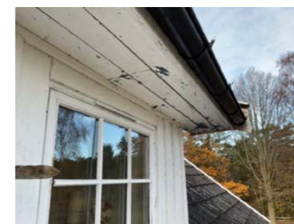
Malingsflass på fasader.
