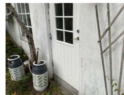
Riss i murpuss.
