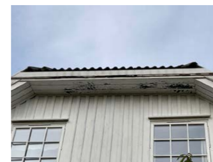
Råte på vindskier og takrennebord.
