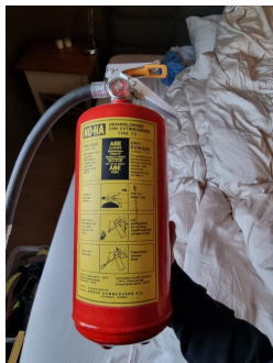
Brannslukningsapparat over 10 år.
