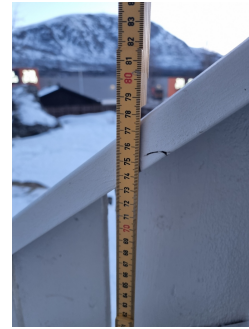
Rekkverkshøyde utvendig trapp.
