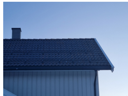
Sorte aluminiums/stål takrenner, nedløp og pipebeslag uten topphatt.
