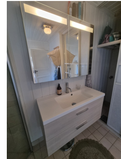
Ikke etablert tettesjikt i våtsone på vegg ved servant.
