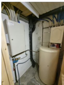
Vannledning fra stoppekran til rør i rør.
