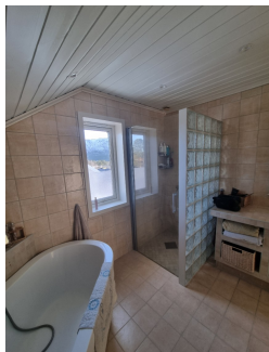
Mekanisk avtrekk og vindusventil.
