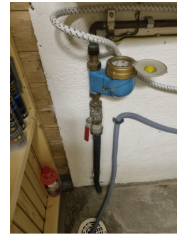
Utvendig vannledning i plast og hovedstoppekran.
