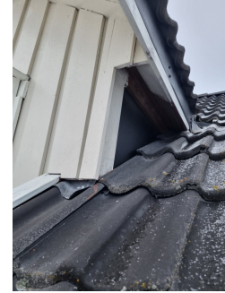
Det er ikke montert beslag fra takstein og inn mot vegg på ark.
