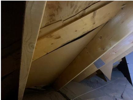
Fuktskjolder i undertak.
