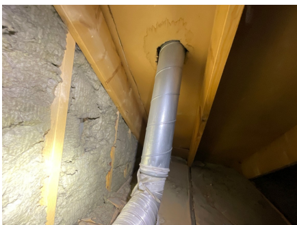
Manglende tetting mellom rør og undertak.
