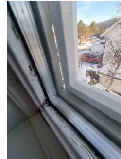
Tegn til kondensering på hovedsoverom i 2 etasje
