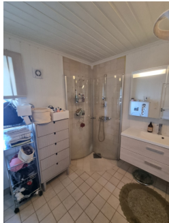
Ikke etablert tettesjikt i våtsone på vegg på utsiden av dusjvegger.
