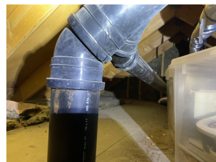
Lufteør på kaldloft mangler isolering.
