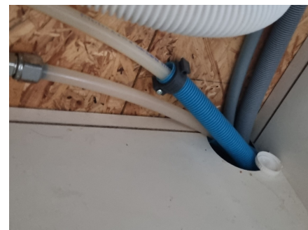
Manglende tettemuffer mellom varerør og pexrør i servantskap på kjøkken.
