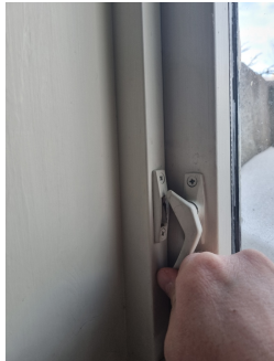
Hasper treffer ikke som de skal på vinduer på soverom i kjelleretasjen.
