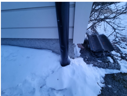
Mindre bulker på taknedløp.
