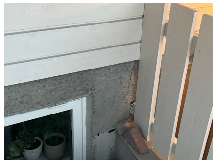
Sprekkdannelse registrert ved kjellernedgang.
