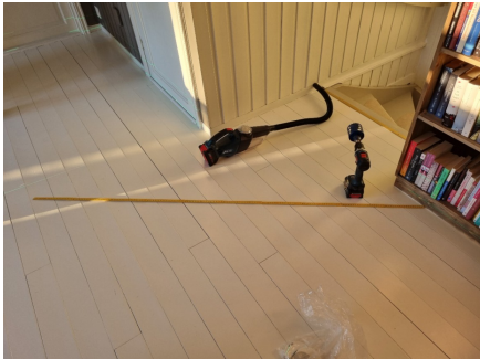
Tomrestokkens plassering viser hvor det ble målt høydeforskjell i etasjeskille på ca. 15mm. innenfor 2 meter.
