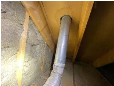
Manglende tetting mellom rør og undertak.
