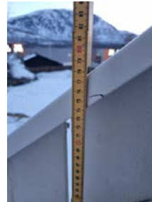
Rekkverkshøyde utvendig trapp.
