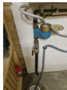
Utvendig vannledning i plast og hovedstoppekran.
