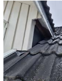
Det er ikke montert beslag fra takstein og inn mot vegg på ark.
