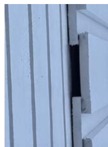
- Det mangler tilstrekkelig med musebånd/sikring under ovebord på stående kledning i 2. etasje.
