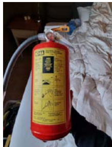
Brannslukningsapparat over 10 år.
