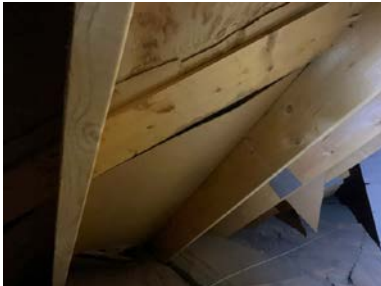
Fuktskjolder i undertak.
