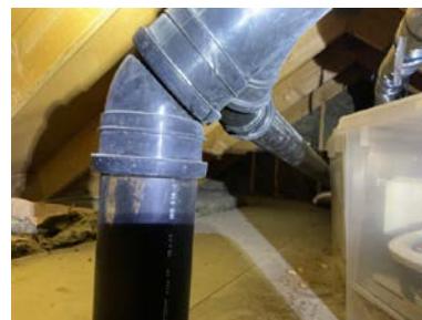
Lufteør på kaldloft mangler isolering.
