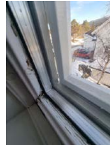
Tegn til kondensering på hovedsoverom i 2 etasje
