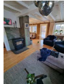
Laser plassert midt i stue i 1. etasje. Det ble målt ca. 15 mm. høydeavvik gjennom hele rommet.
