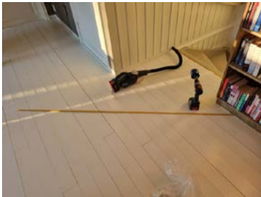
Tommestokkens plassering viser hvor det ble målt høydeforskjell i etasjeskille på ca. 15mm. innenfor 2 meter.
