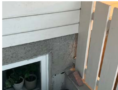
Sprekkdannelse registrert ved kjellernedgang.
