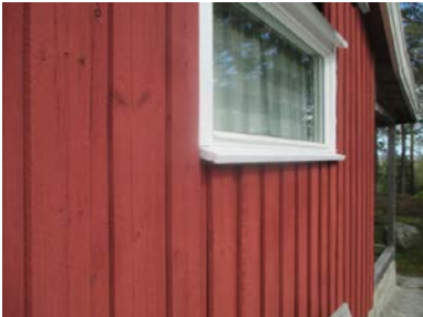
Kledning noe soltørket og værslitt
