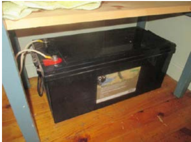
Batteribank er plassert i entre
