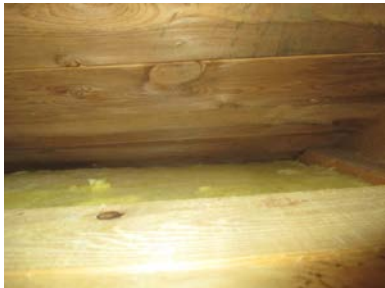
Ingen luftespalte i mellom isolasjon og undertak.
