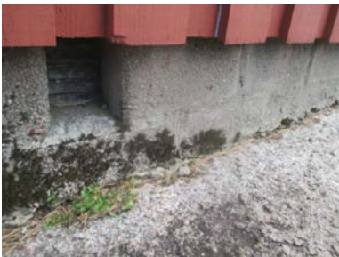
Er en del ventiler til kryp kjeller.
