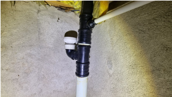
Lufting via vakumsventil.
