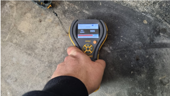
Det ble registrert forhøyde fuktverdier
