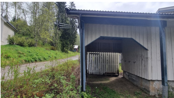
Yttervegg har store skjevheter.
