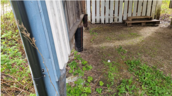
Skjevheter i fundamenter.
