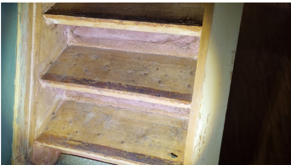
Trapp har overflateslitasje.
