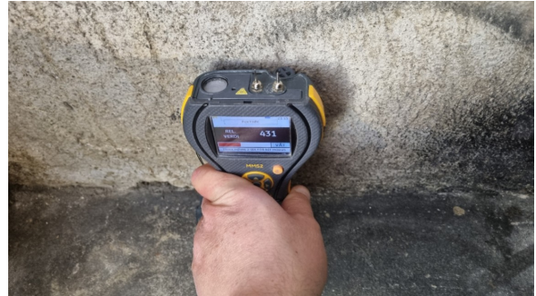
Det ble registrert forhøyde fuktverdier.
