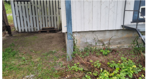
Skjevheter i fundament og søyle.
