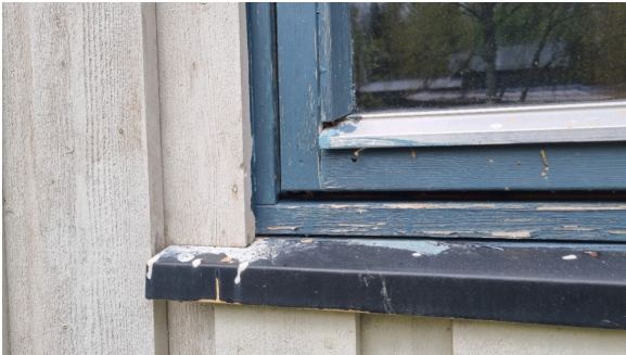
Vindu har værslitasje.
