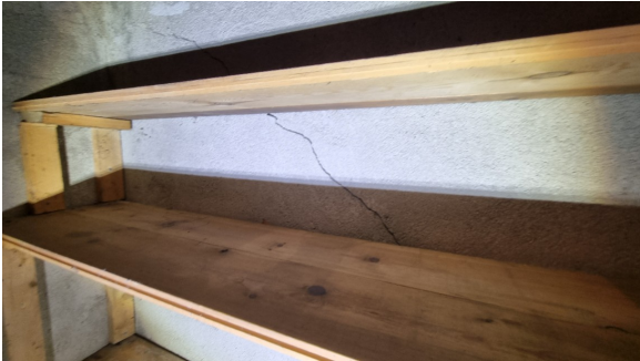
Sprekk i grunnmur.
