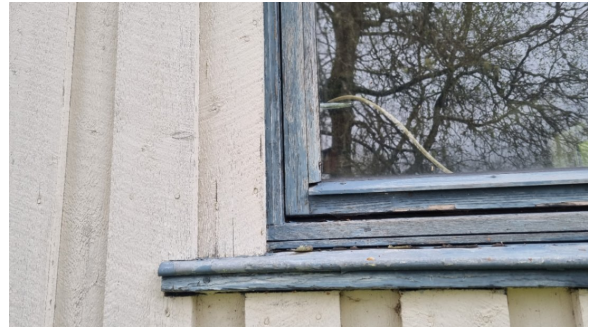
Vindu har værslitasje.
