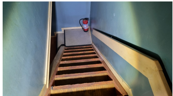
Trapp mangler rekkverk.
