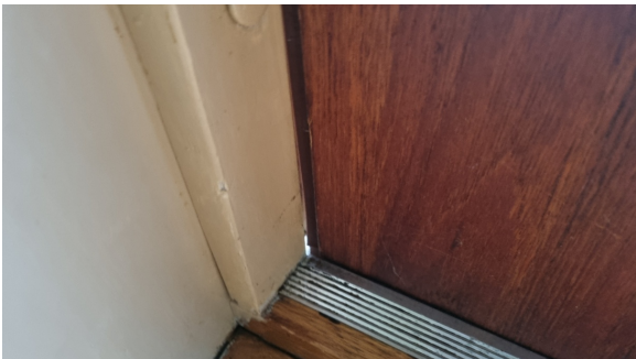
Det er påvist utetthet/åpning mellom dørblad og dørkarm. Dvs. at kald trekk kan oppstå.
