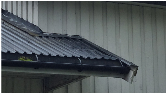
Skade i takplater
