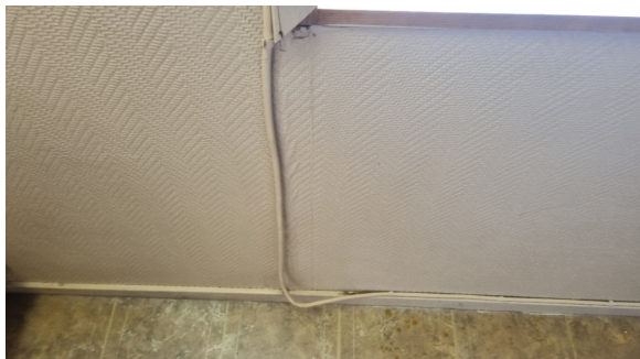
Ledning er ikke tilfredsstillende festet.
