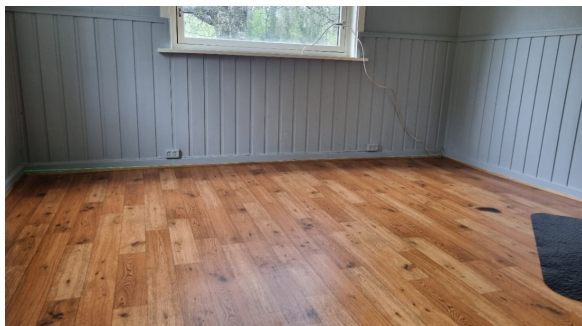
Visuelle skjevheter i gulvet på stuen.
