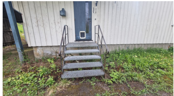
Dør er værslitt. Det bemerkes at katteluke vil føre til dårligere isolasjonsevne.
