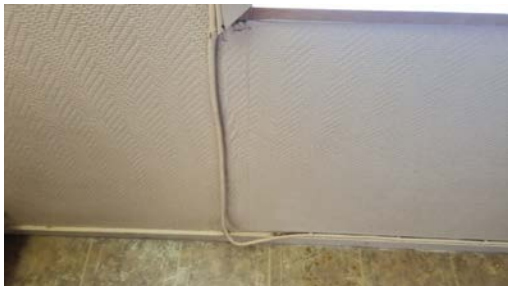
Ledning er ikke tilfredsstillende festet.
