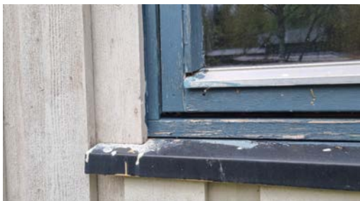
Vindu har værslitasje.
