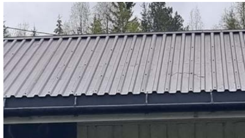
Det er synlige merker av spikerlekter i takplater.
