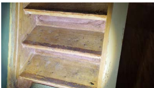
Trapp har overflateslitasje.
