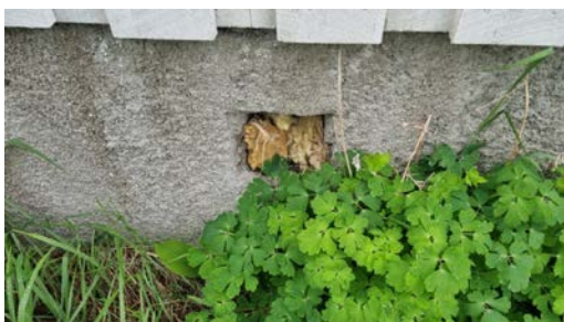
Det er registrert ventiler i kjelleretasjen som er tettet igjen og mangler utvendig ventilrist.
