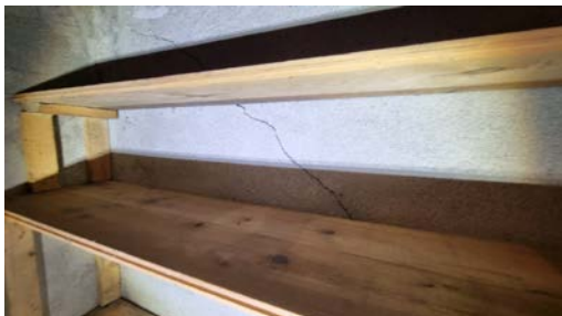
Sprekk i grunnmur.
