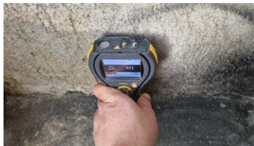
Det ble registrert forhøyde fuktverdier.
