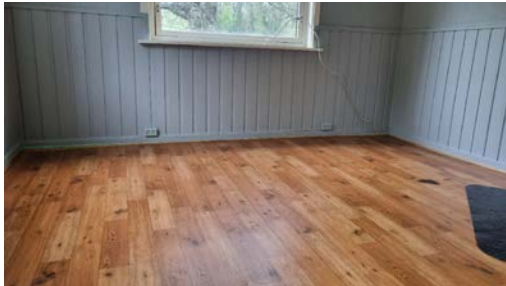
Visuelle skjevheter i gulvet på stuen.
