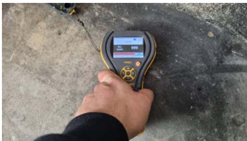
Det ble registrert forhøyde fuktverdier
