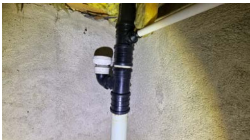
Lufting via vakumsventil.
