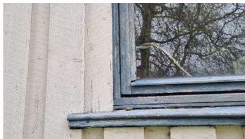
Vindu har værslitasje.
