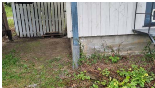
Skjevheter i fundament og søyle.
