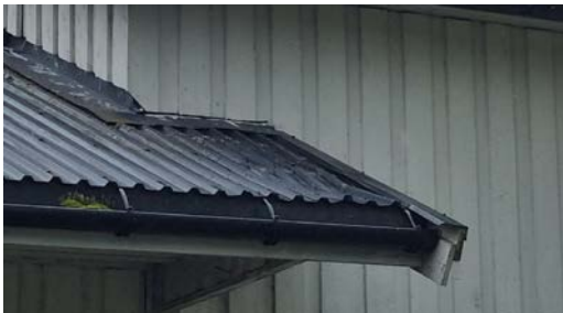
Skade i takplater
