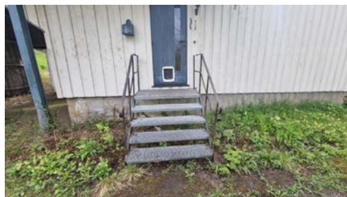
Dør er værslitt. Det bemerkes at katteluke vil føre til dårligere isolasjonsevne.
