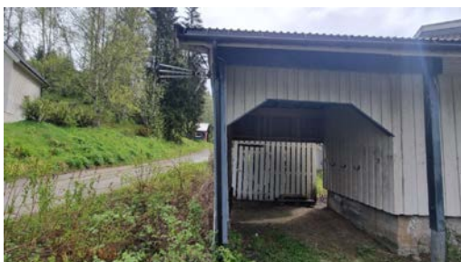
Yttervegg har store skjevheter.
