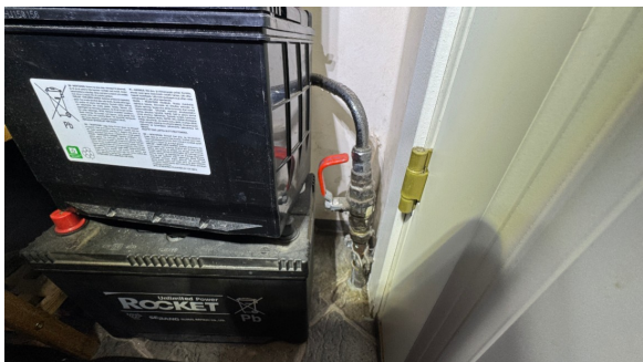
Det er registrert noe kondens på kobberrør.
