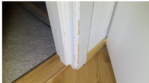
Det er registrert noe slitasje på dørlister.
