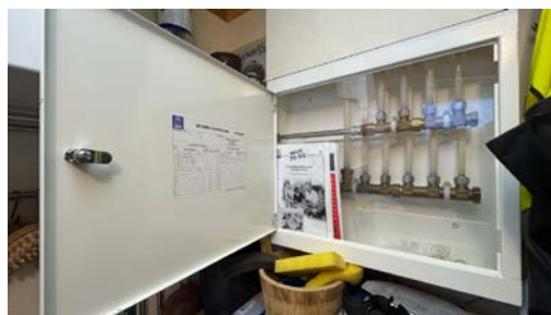
Kontroll av rørfordelerskap.
