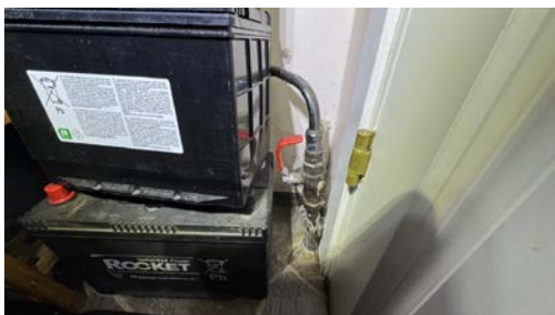
Det er registrert noe kondens på kobberrør.
