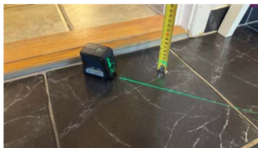
Målinger viser at det ikke er fall til sluk (motfall).
