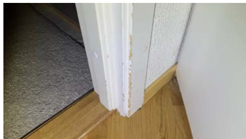
Det er registrert noe slitasje på dørlister.
