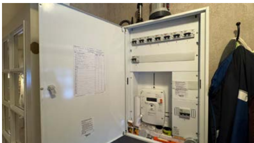
Kontroll av el-skap og kursfortegnelse.
