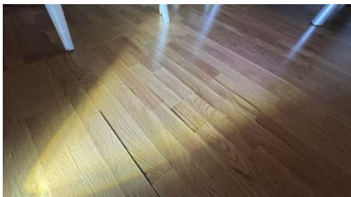
Det er registrert noe slitasje på parkett.
