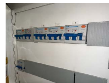
Sikringsskap med automatsikringer.
