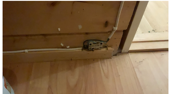
Åpne koblinger og løse ledninger.
