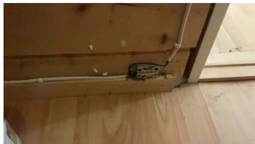
Åpne koblinger og løse ledninger.
