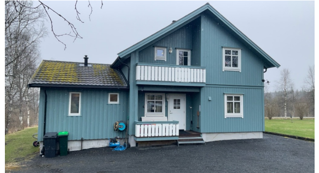
Mose på tak mot nord.
