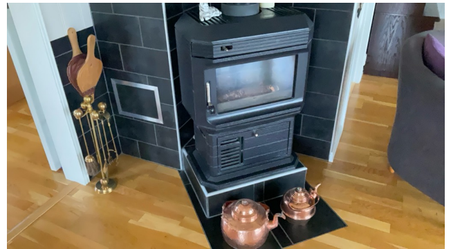
Manglende ildfast plate på gulv under sotluke.
