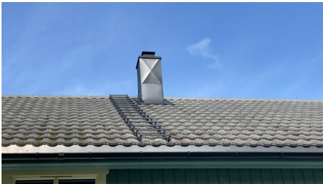
Pipehatt og stige til pipen.
