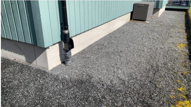
Nedløp tilkoblet overvannsrør.
