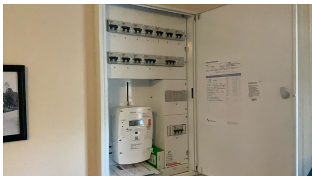
Sikringskap med automatsikringer.
