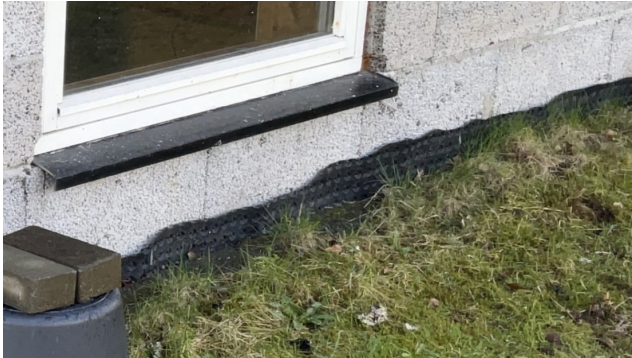
Manglende klemplast på grunnmursplast.
