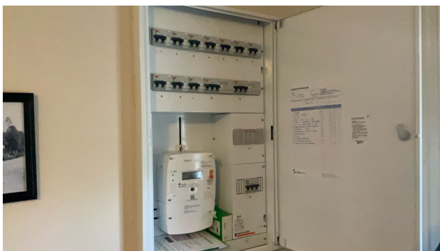
Sikringskap med automatsikringer.
