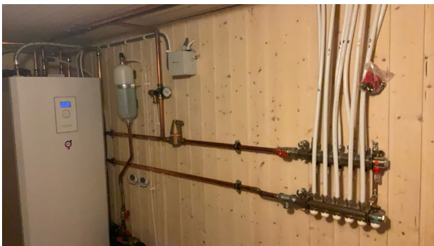
Kjellerbod med bereder og røropplegg.
