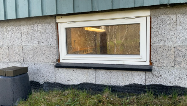
Manglende fugging av vinduer.
