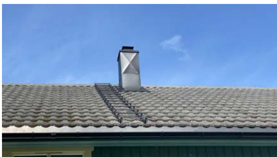
Pipehatt og stige til pipen.
