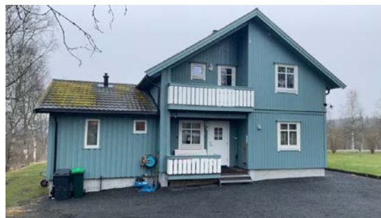
Mose på tak mot nord.
