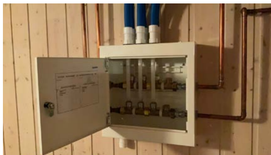
Rørskap til bad.
