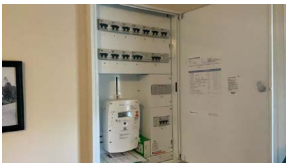
Sikringsskap med automatsikringer.
