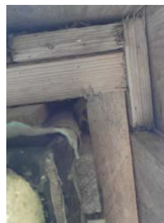
Det er påvist manglende eller åpninger i musesperre der mus kan komme inn i vegg konstruksjonen.
