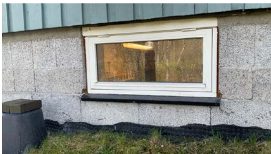
Manglende fuging av vinduer.
