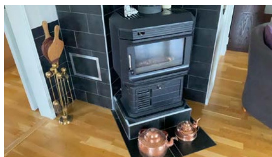
Manglende ildfast plate på gulv under sotluke.
