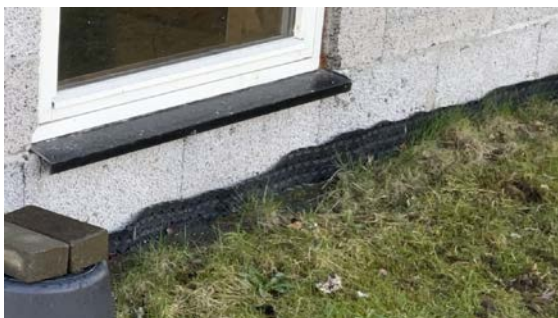
Manglende klemlist på grunnmursplast.
