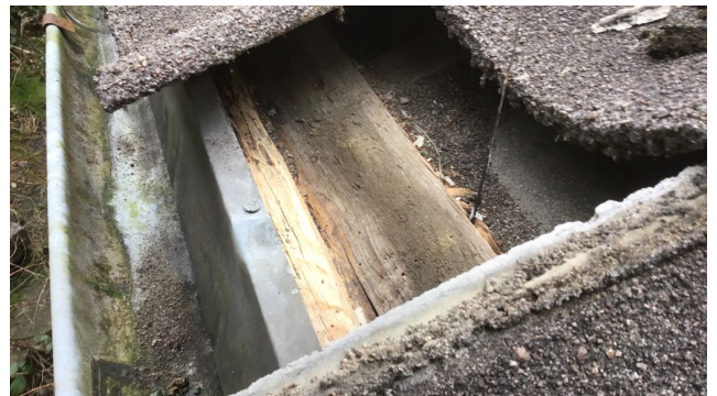
Råteskader i lekter/sløyfer
