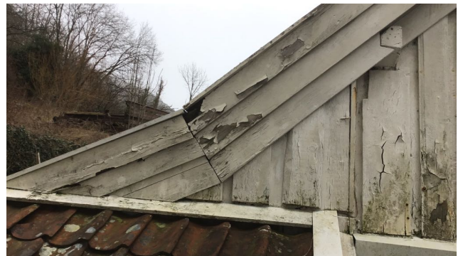
Råteskader i vinds kier
