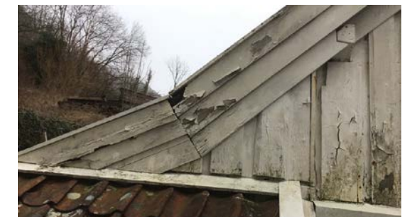
Råteskader i vindskier
