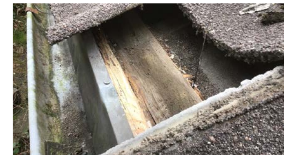
Råteskader i lekter/sløyfer
