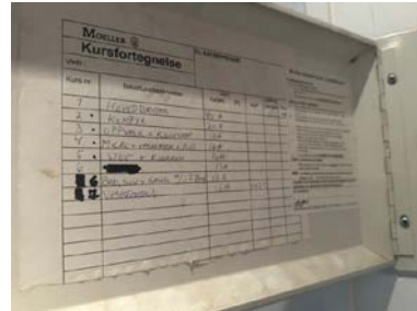
Kursoversikt i sikringsskap
