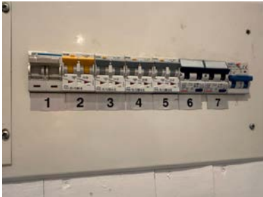
Sikringsskap med automatsikringer.
