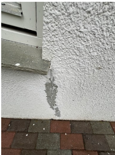
Riss i betongvegg.
