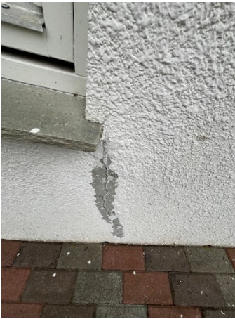
Riss i betongvegg.
