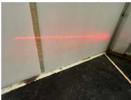
misfarge / sluppet silikon i dusjsone.
