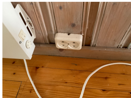
Skade på stikkontakt.
