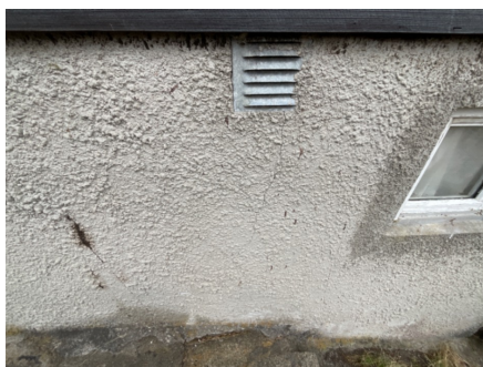
Riss/sprekk i grunnmur.
