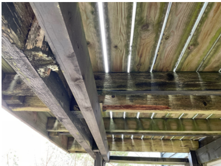
Konstruksjon med råte.
