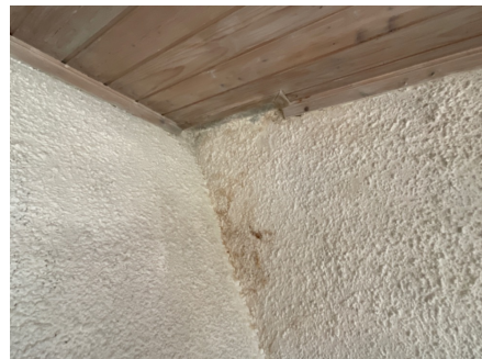
Fuktskjolder og saltutslag på pipe/brannmur.
