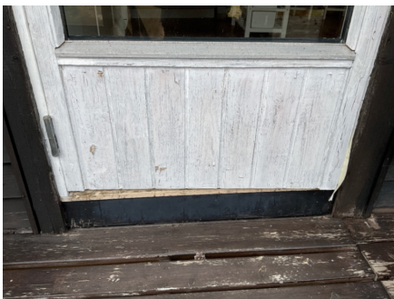
Terrassedør med værslitasje
