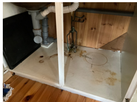
Fuktskjolder og svelling på bunnplate.
