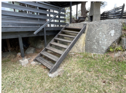
Trapp som mangler rekkverk.
