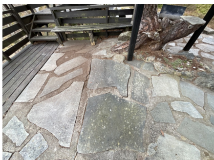
Skifer med løse fuger.
