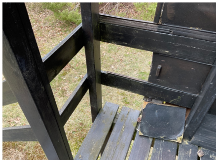
Rekkverk med for stor åpning.
