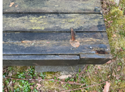
Gulvbord med grønske og råte.
