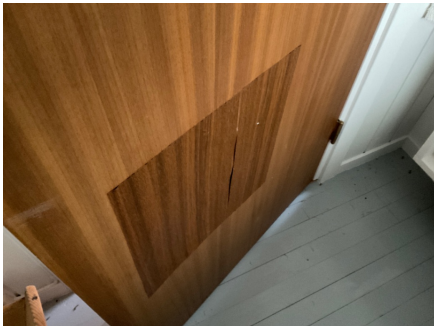
Skade på innside av dør.
