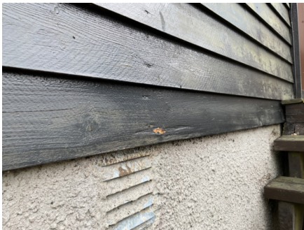
Begynnende råte på kledning.
