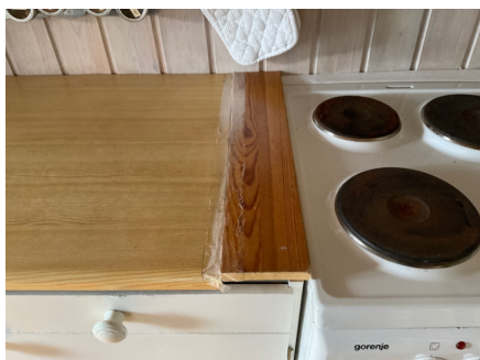
Ufagmessig skjøt av benkeplate.
