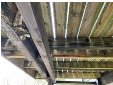
Konstruksjon med råte.
