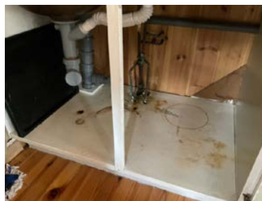
Fuktskjolder og svelling på bunnplate.
