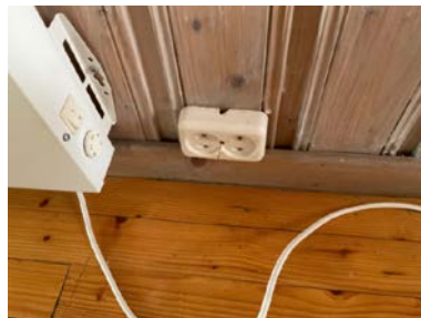
Skade på stikkontakt.
