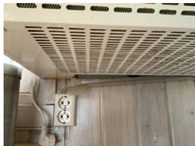
Ødelagt deksel til lyspære.
