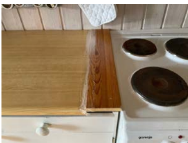
Ufagmessig skjøt av benkeplate.
