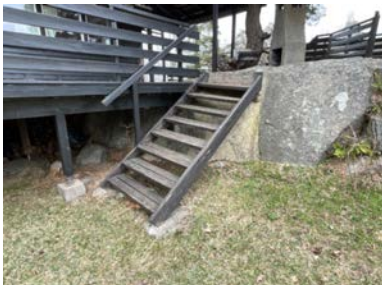
Trapp som mangler rekkverk.
