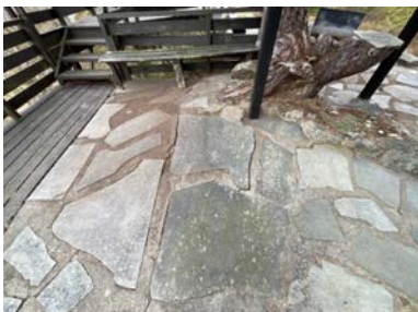
Skifer med løse fuger.
