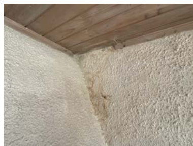
Fuktskjolder og saltutslag på pipe/brannmur.
