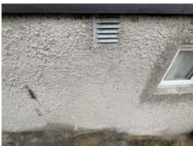
Riss/spekk i grunnmur.
