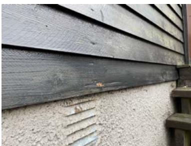
Begynnende råde på kledning.
