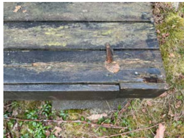
Gulvbord med grønske og råte.
