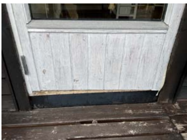
Terrassedør med værslitasje
