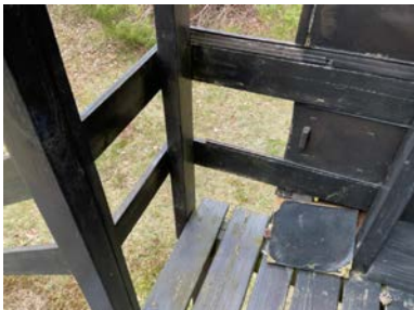
Rekkverk med for stor åpning.
