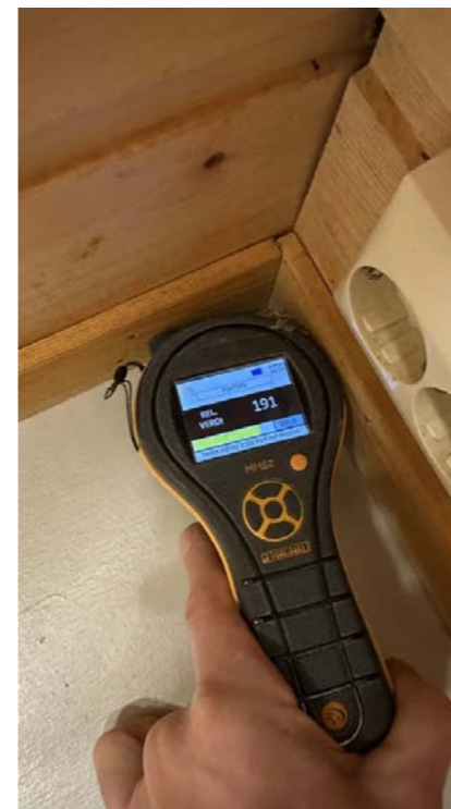
Kjeller Bod ved trapp. -Høyere fuktverdier i ytre del av oppforet gulv ved yttervegg.
