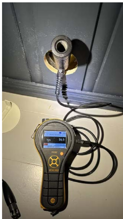
Kjeller Soverom/kontor. -Høyere fuktverdier i påforet yttervegg.
