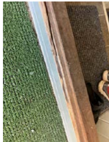
Skade terskel ytterdør inngang utleiedel
