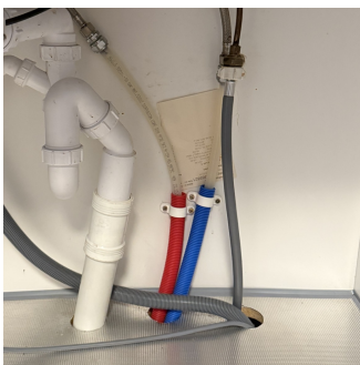
Manglende muffer på vannrør
