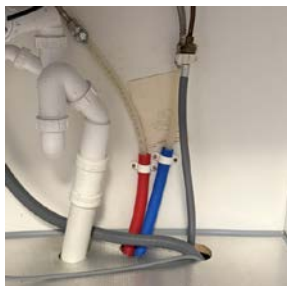
Manglende muffer på vannrør
