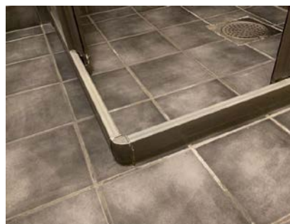
Terskel til dusjhjørne hindrer lekkasjevan i å renne til sluk.
