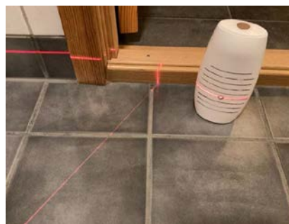
Flatt gulv utenfor dusjhjørne.
